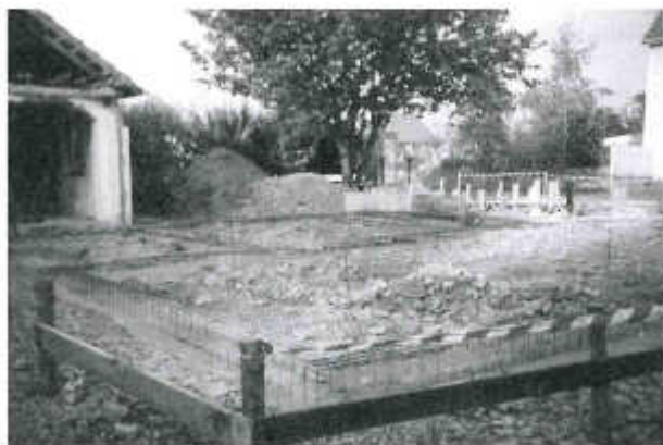
Abbildung 1.13: Das neue Feuerwehrhaus im Entstehen von den Fundamenten, der Sohle bis zum Rohbau
